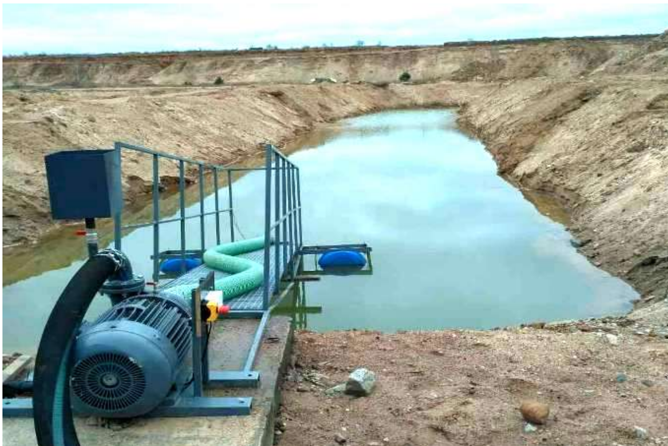
Рис. Насосная установка перекачки оборотной воды из отстойника №3 в гидроклассификатор
